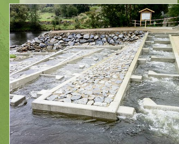
Fertiger Schlitzpass in Betrieb.
